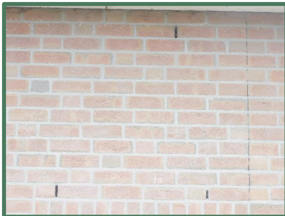
Open stootvoegen in spouwmuur paardencentrum
